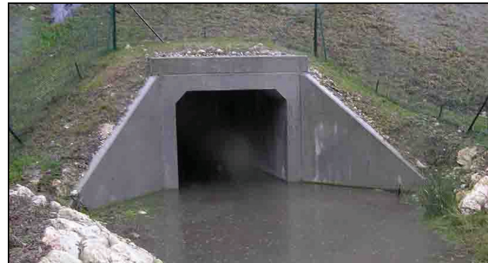
Exemple d'ouvrage hydraulique : dalot 2 m x 2 m (© SETEC International)
